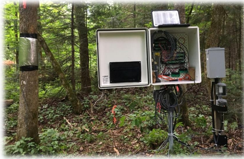
Une partie des équipements installés à la Réserve naturelle de la Vallée-de-la-Rivière-Noire © Projet Forêts Intelligentes
