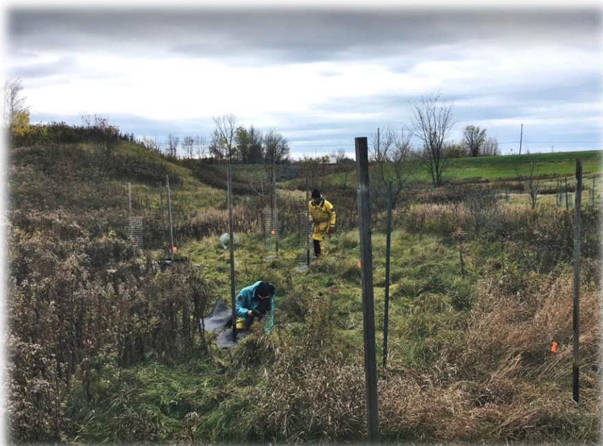
Travaux de plantation dans le corridor reliant le bois de St-Thomas/Ste-Élisabeth et le massif boisé de la tourbière de Lanoraie. © FCEL
